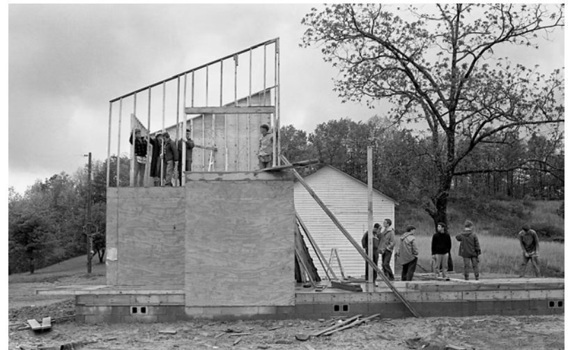
55. Κατά τη διάρκεια κατασκευής του Νέου Κοινοτικού Κέντρου της Σιών, το πρώτο έργο του Yale Building Project, New Zion, Kentucky, 1967.
