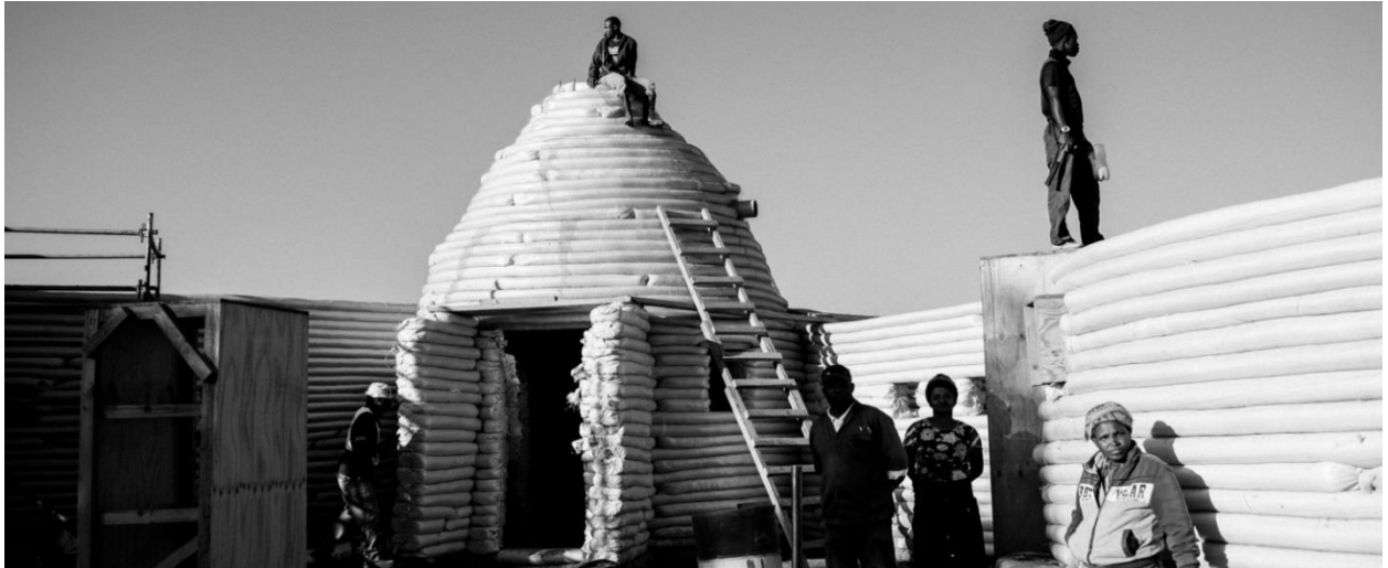
εικ.1.17. Το Langbos Children's Centre κατά την κατασκευή. (ανακτήθηκε από: https://www.archdaily.com/942147/langbos-childrens-centre-jason-erlank-architects στις 13/11/21).
