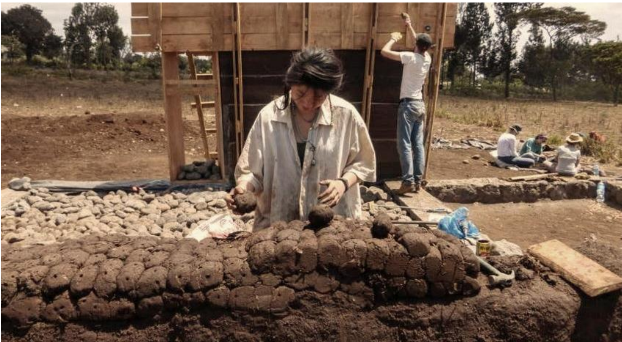
εικ.1.10. Κατασκευή τοίχου με την τεχνική του cob. (ανακτήθηκε από: https://www.researchgate.net/figure/Construction-of-a-cob-wall-by-stacking-mud-balls-Phototanzaniagoesmudwordpresscom_fig4_323171283 στις 12/11/21).
