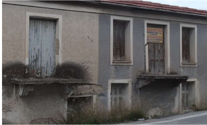
Εικόνα 5.6 Εξώστες ω.σ. σε πλιθινη διπλή κατοικία με εμφανές πρόβλημα υγρασίας.
