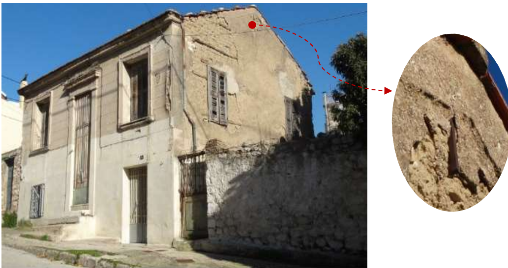
Εικόνα 3.31 Κατοικία με ελκυστήρα που συνδέει τους απέναντι αετωματικούς τοίχους στην άνω πόλη Πατρών.
