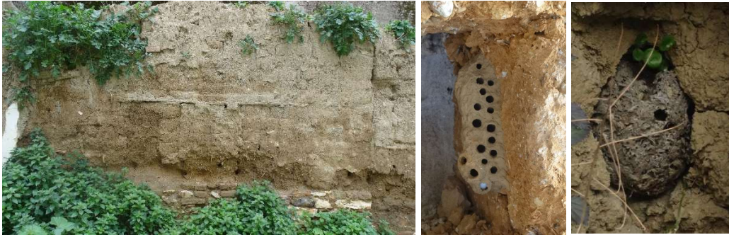
Εικόνα 4.6 Βλάστηση σε ωμοπλινθοδομή και Εικόνες 4.7 & 4.8 Φωλιές εντόμων
