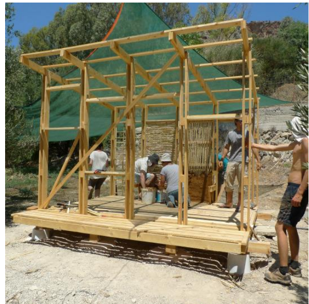
"Εικόνα 2: Ξύλινος φορέας της πειραματικής κατασκευής."
